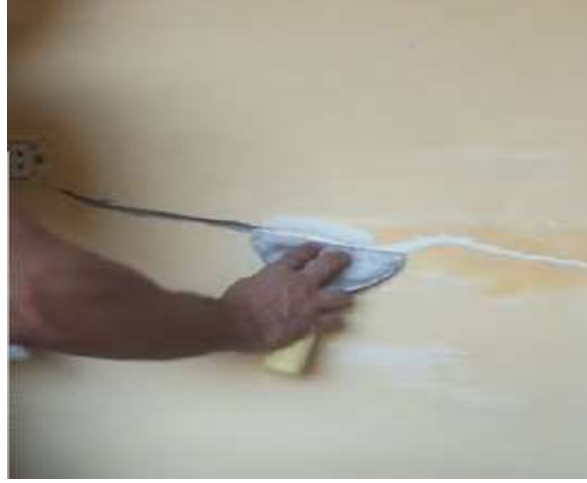
الشكل رقم ( ١٢ ) يوضح عملية معالجة الشقوق او الثقوب
